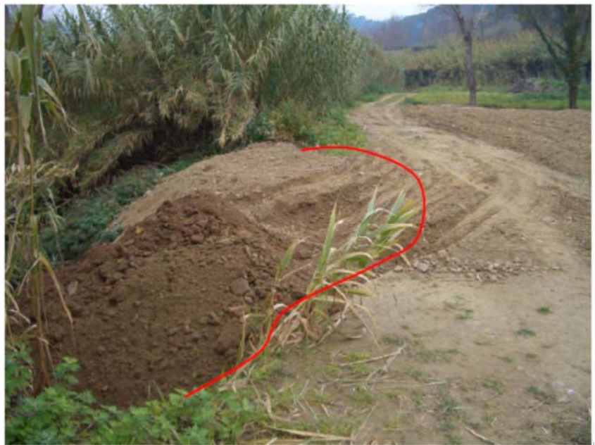
Foto 5. Fenomeno gravitativo in corrispondenza dell'orlo della scarpata che ha invaso la viabilità poderale. Nonostante la presenza di terreno di riporto con funzione di inutile riempimento è ben visibile la corona dell'area in frana.
