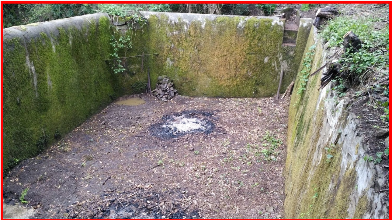
Immagine della grande vasca di accumulo dell'acqua. In alto a destra si nota il canale di adduzione delle acque.
